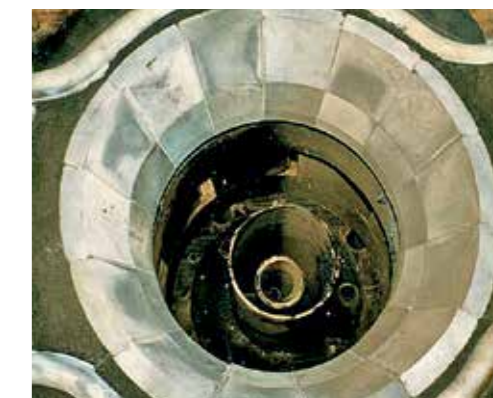
Protection de réflecteurs de brûleurs à charbon pulvérisé réalisée en KALSICA N ou KALMETALL.
