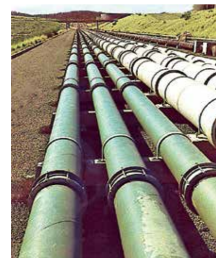
Conduites hydrauliques et pneumatiques anti-usure
