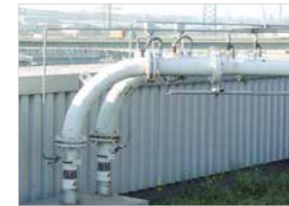
KALDETECT dans une usine allemande d'incinération de déchets
