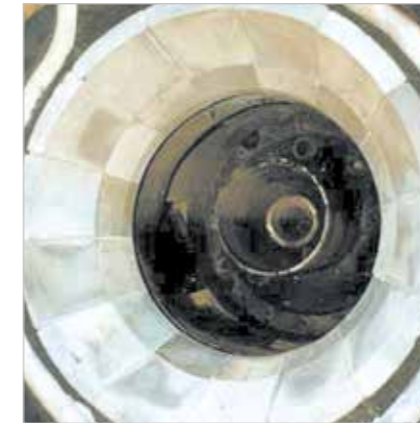
Cône de brûleur protégé en KALSICA dans une centrale thermique
