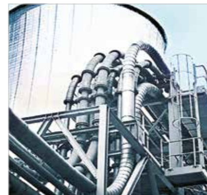
Conduites véhiculant des cendres volantes dans une centrale thermique
