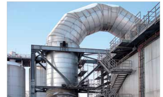
Tuyau de transport de poussière de clinker fonctionnant dans une cimenterie
