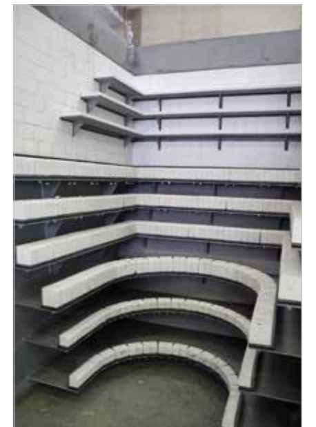
Goulotte en cascade équipée de blocs d'usure en céramique d'alumine KALOCER épaisseur 100 mm. La céramique est fixée sur les déflecteurs avec du matériau de pose KALFIX. Les déflecteurs sont vissés en biais sur la goulotte.
