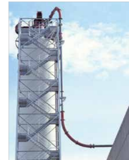
Les conduites d'alimentation des silos à ciment sont protégées par un blindage en ABRESIST dans les coudes et dans les tronçons droits qui les suivent
