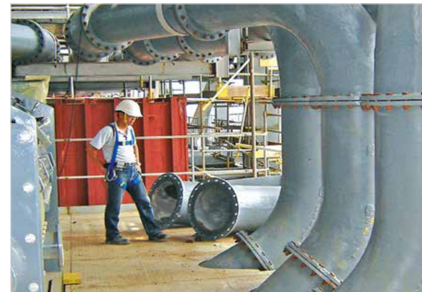
Les tuyauteries sont une application typique de la fonte alliée anti-usure KALCAST ; ici des conduites véhiculant du charbon pulvérisé dans une centrale thermique en Asie du Sud-Est
