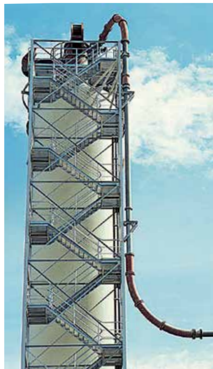
Tuyauterie de transport vers les silos à ciment ; les coudes et leurs manchettes de sortie sont protégés en ABRESIST
