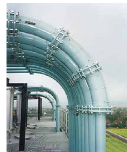
Conduites équipées d'une protection pneumatique et hydraulique
