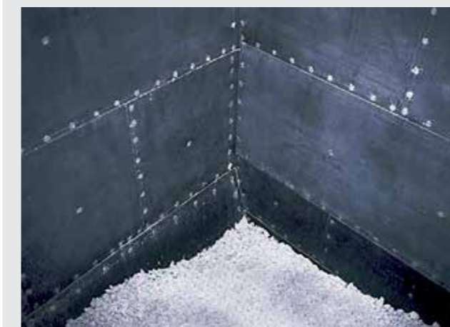
Trémie à farine crue équipée d'un revêtement améliorant le glissement KALEN 1006
