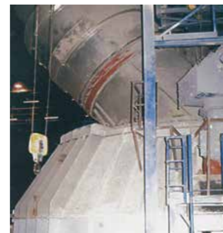
Protection d'un broyeur à farine crue : réalisée en KALCRET pour le système de tuyauterie, en KALMETALL W100 pour le broyeur
